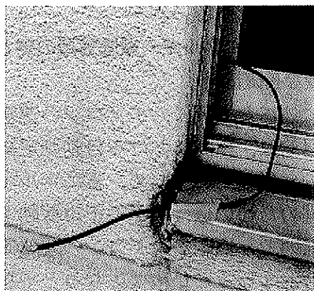
写真2 熱電対センサーの取付け例
