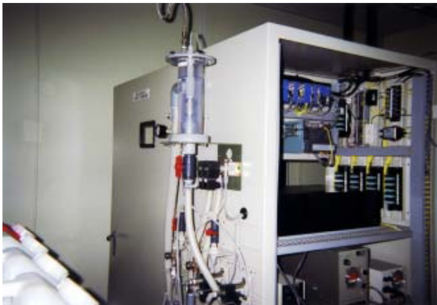
全窒素・全りん計(NP1000型) 写真中央左に見える筒や配管が前処理装置となっている。
