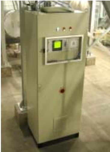
国内の清掃工場に設置された アメサ本体(制御ユニット)
