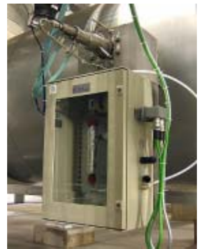
横煙道に設置されたアメサ採取部 排ガスは上部の採取管を通り ボックス内の銀色捕集管に入る
