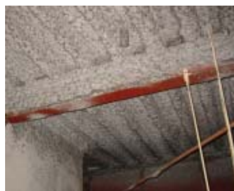
アスベストに覆われた天井
